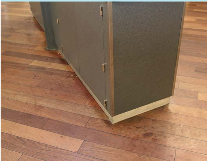
Vor der Grundreinigung und Pflege ist der Boden im Take-away-Bereich voller Flecken, stumpf und schlecht gegen äußere Einflüsse geschützt.
